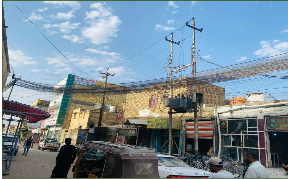
صورة (2) توضح تشابك الاسلاك الكهربائية والتشوه الجمالي في مدينة الرفاعي.
